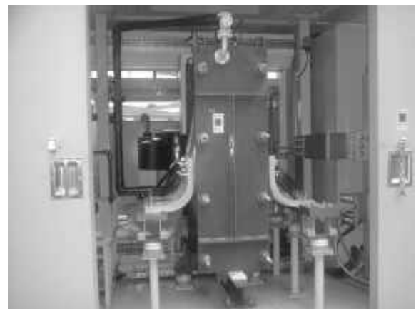
写真-2 電解層の外観
