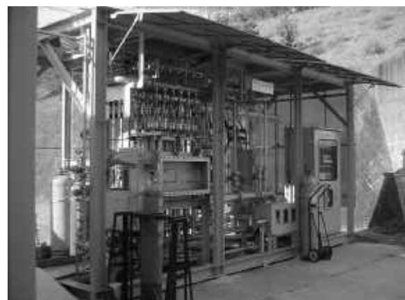
写真-3 メタン製造装置外観
