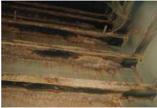
二重船側内の著しい発錆の様子
