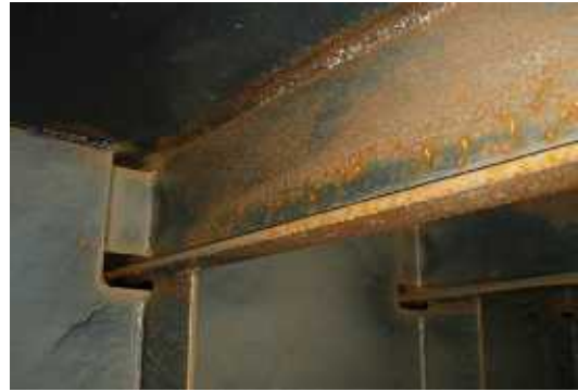
ロングだけに錆が集中している様子
