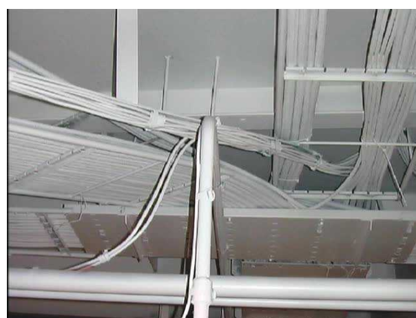
配管の障害物(電路)
