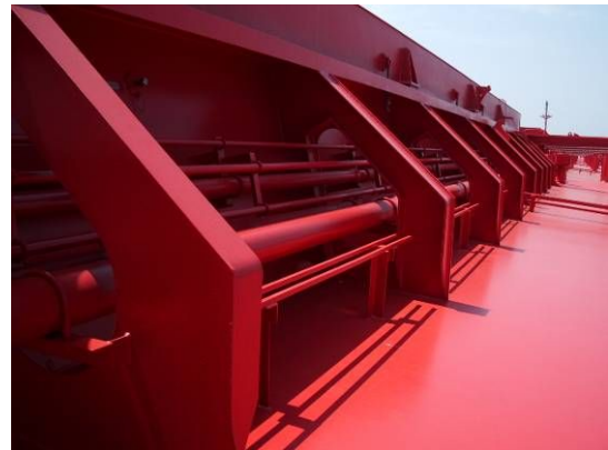
ハッチカバー脇の配管
