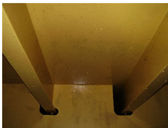
バラストタンクに塗布した VOC 量 50g/L の防食塗料の 2 年後の状況 ・ 平坦部及びエッジ部共に良好な状態
