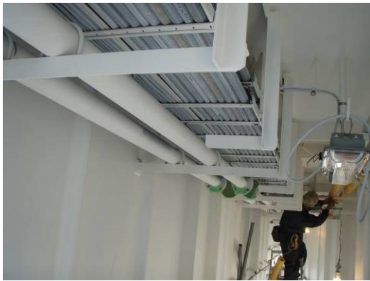
管路と電路が平行しているが金物は別
