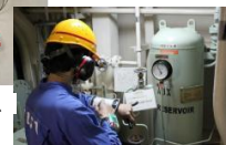
機関室でのシステム入力状況
