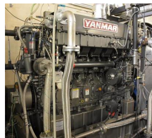
ガスエンジンの外観
