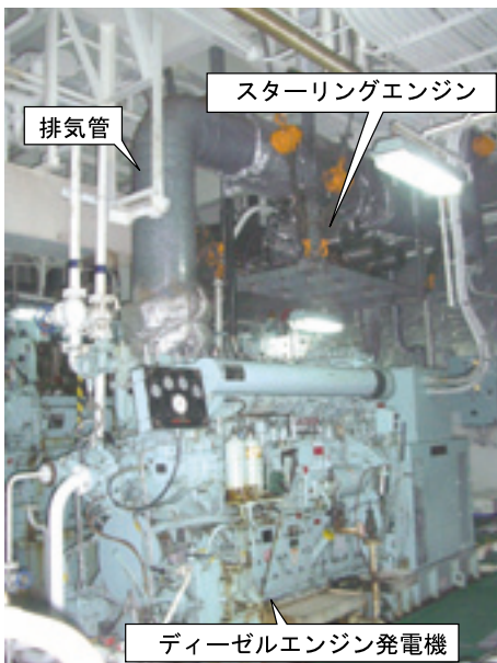
図8 船内に設置したスターリングエンジン
