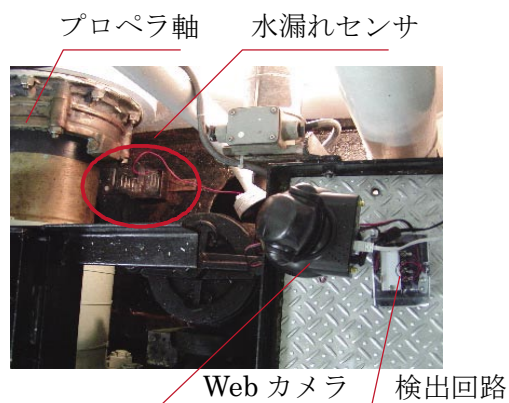
図4 水漏れ検知回路とカメラ(上方より)
