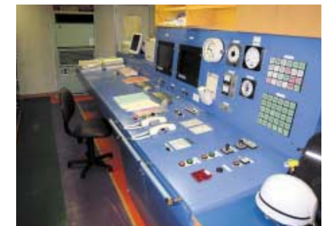
図9 エンジンコントロールルーム
