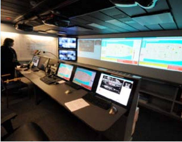
写真2 セーフティコントロール室
