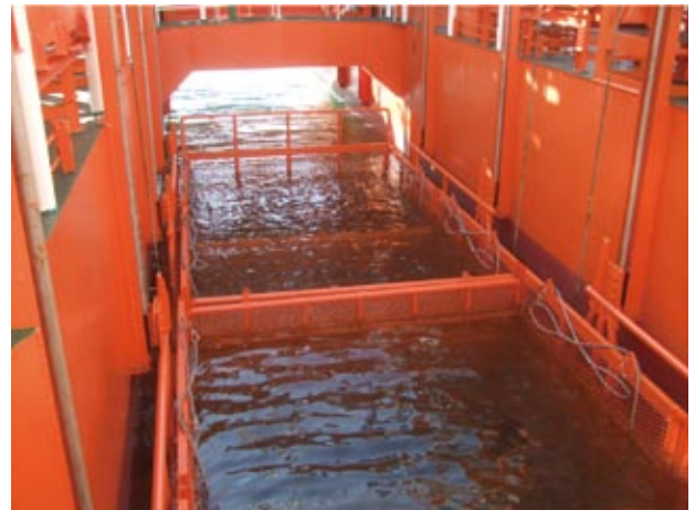
写真2 ゴミ回収装置(下降状態)
