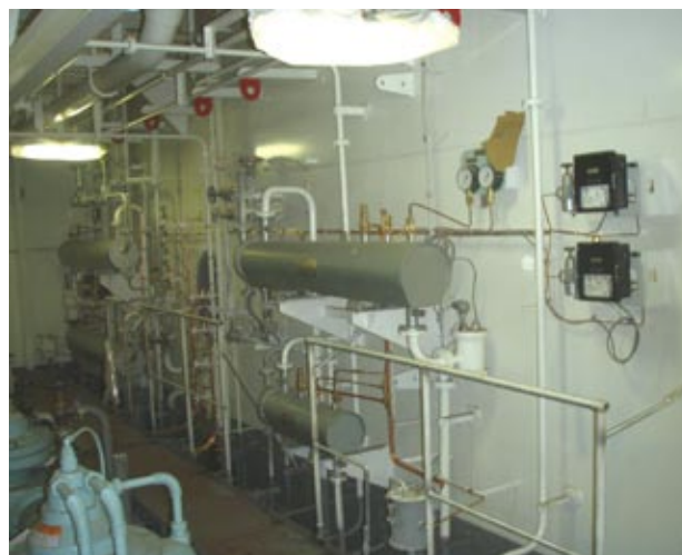
図1 機関室内の様子
