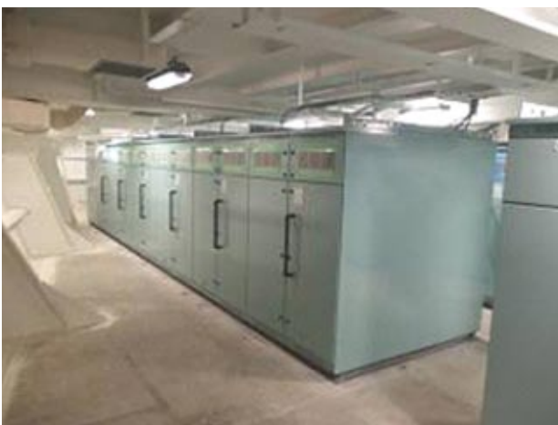
写真3 蓄電池室の電池盤
