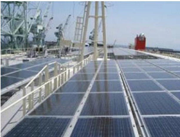
写真2 甲板上の太陽光パネル
