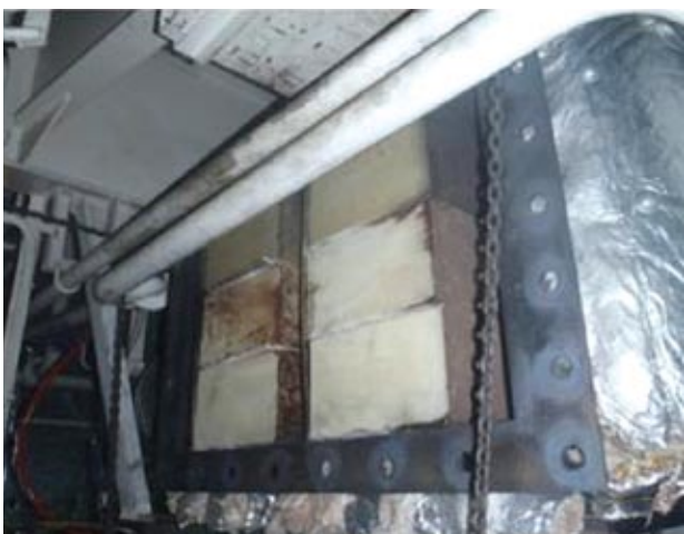
図2 実船搭載された SCR 装置
