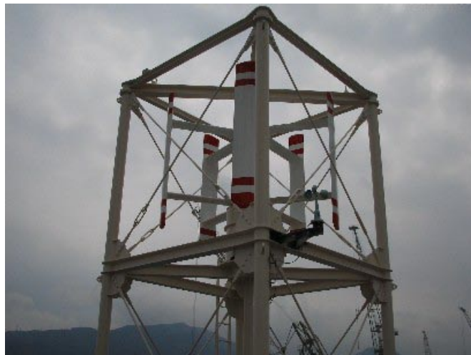
(風力発電装置)
