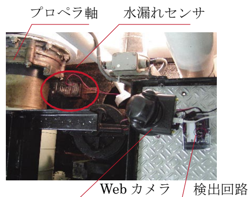
図4 水漏れ検知回路とカメラ(上方より)
