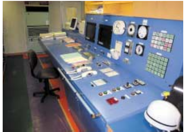
図9 エンジンコントロールルーム
