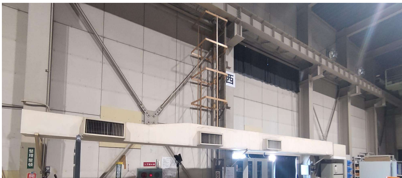
図1 エアコンダクト全体
