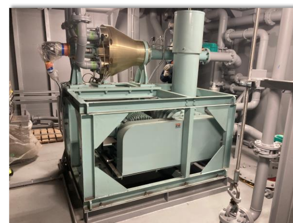
空気潤滑システム （ブロワ、周期吹き出し装置）
