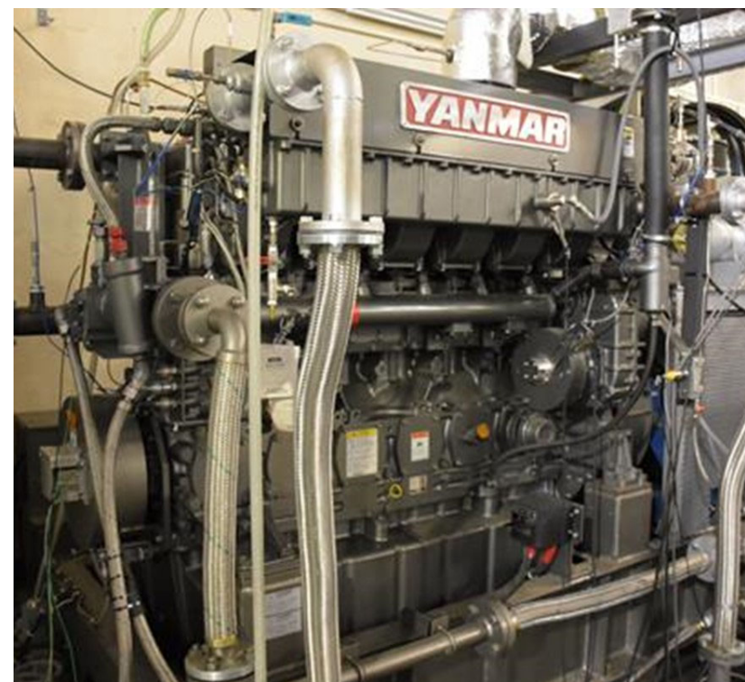
ガス機関の外観
