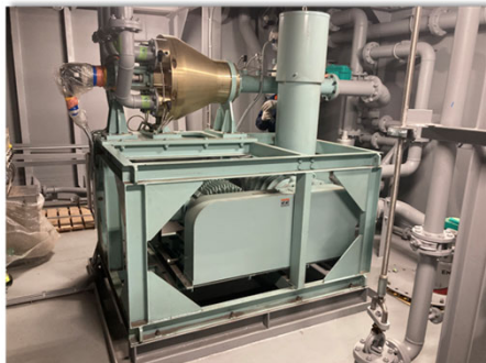
空気潤滑システム (ブロウ、周期吹き出し装置)
