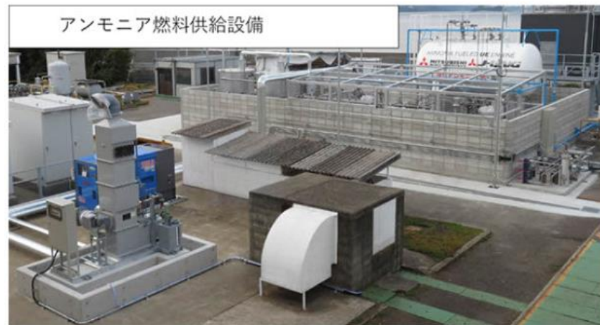
アンモニア燃料供給設備 及び関連機器
