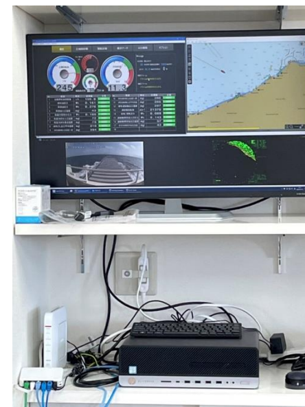
事務所モニタ設置
