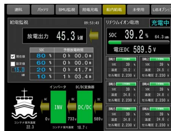
バッテリー監視画面
