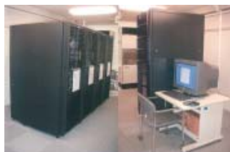
大規模計算サーバー(左)とグラフィックスサーバー(右)です
