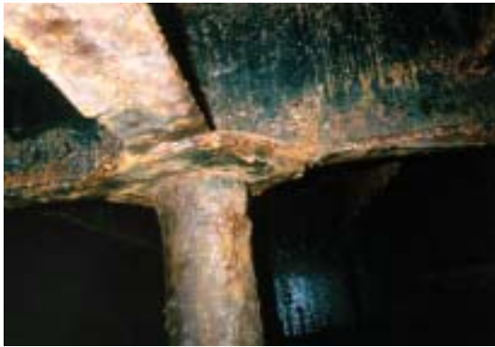
Photo.5 暴露甲板下の腐食
