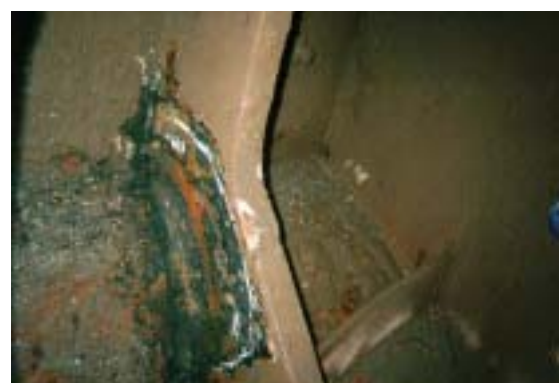
Photo.4 座屈した内部構造部材
