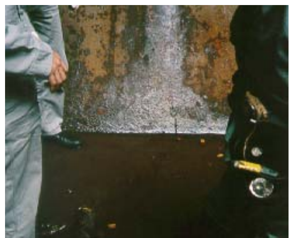
Photo.10 カーゴホールド内の亀裂 その2
