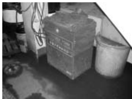
写真 C.27 持ち運び式泡消火器（9 リットル）
