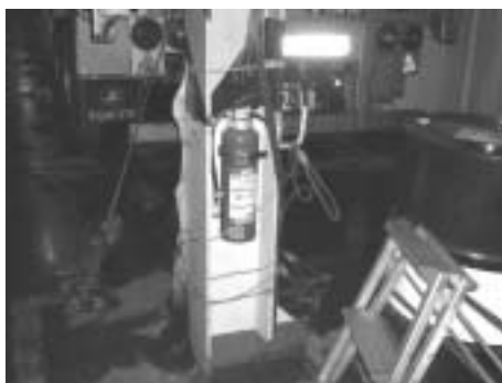
写真 C.26 持ち運び式消火器
