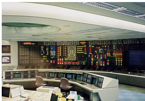
図-2 原子力プラント中央操作室（第三世代）
