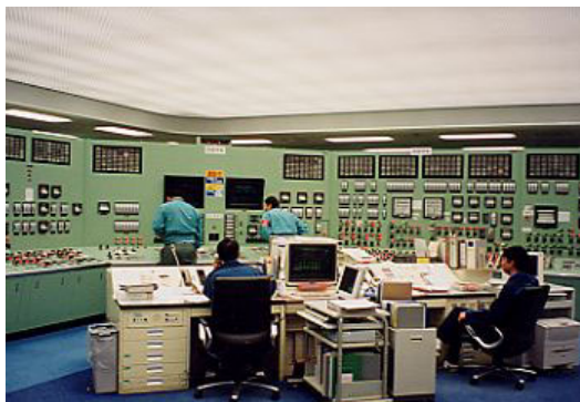
図-1 原子力プラント中央操作室（第二世代）
