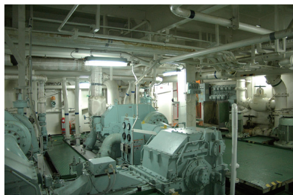
図 5.8 排熱回収により得られた電力を船内電力の一部に供給をしている様子
