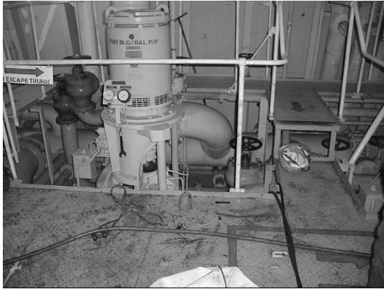
図-12 バラスト水用ポンプ（5万トンクラスで600m 3 /hのポンプ1～2台、15万トンクラスでは2,500m 3 /h, 2台）
