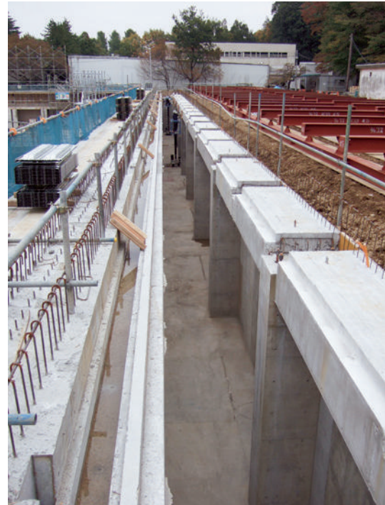
図-3.8 水槽壁面 (左) と建家基礎 (右) (水槽南西より東を臨む)
