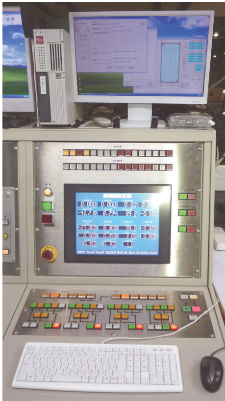
図-4.2 曳引台車運転操作卓(主台車計測室内)
