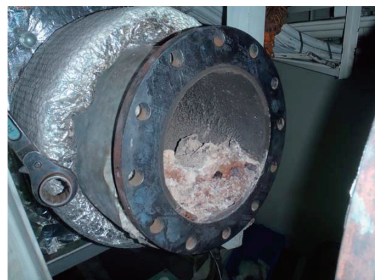
図-7.11 排気管中に堆積した固形物
