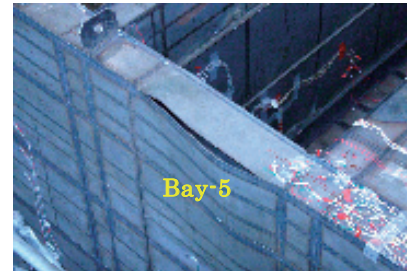
(f) 船側外板上部の破断
