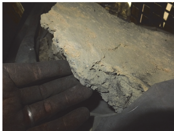
(b) サイレンサ内部に堆積した触媒
