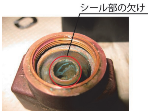
(c) シール部の破損 (2012 年 8 月)
