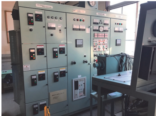
(a) 実機の配電盤
