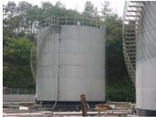
付図8 油槽所タンク
