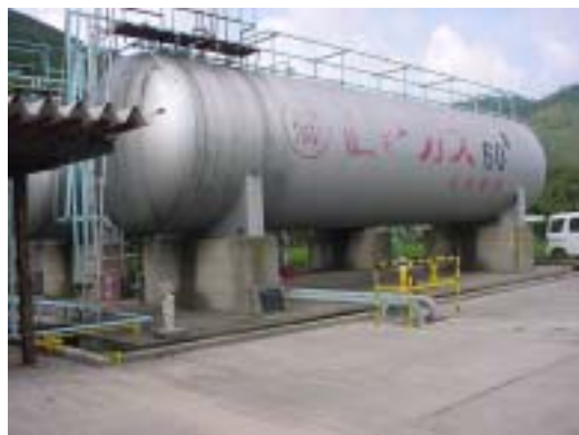
付図10 LPガスタンク
