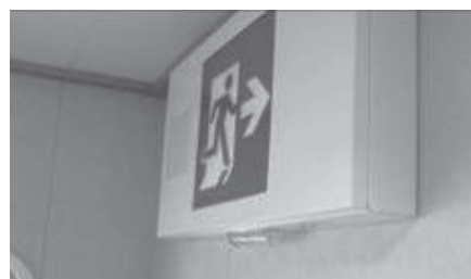
図 14 フラッシングライト付き 非常口案内表示
