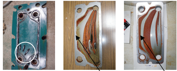
整流板3箇所 整流板有り錆無し 整流板無し錆有り 図-7 整流板による流れの比較
