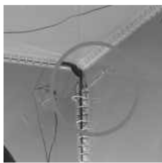
写真 3.2 緊張材の破断 および側外板の破壊
