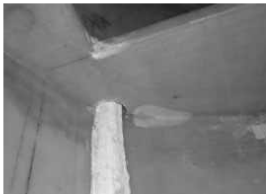
写真 3.5 船底パネルと隔壁間の剥離
